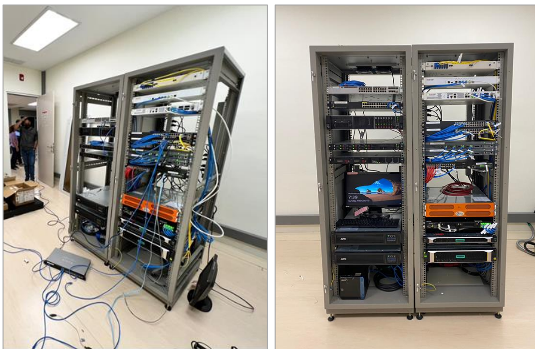
ภาพที่ ๑๕ : การติดตั้งอุปกรณ์เครือข่าย ห้อง Server ชั้น ๑๓
