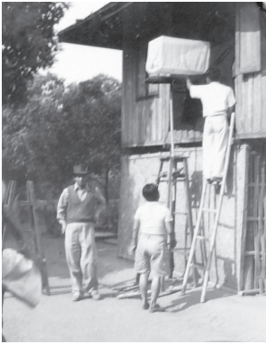
Dr.Bathia กำลังควบคุมการติดตั้ง Window Trap เพื่อกันยุง ตัวผลของ DDT ซึ่งทดลองพบไว้ในบ้าน เป็นโครงการควบคุมไข้มาลาเรียที่อำเภอสารภี
