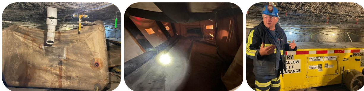
ภาพที่ 2 ลักษณะ Shelter ภายนอกและภายใน และตู้ควบคุมระบบหมุนเวียนอากาศ
